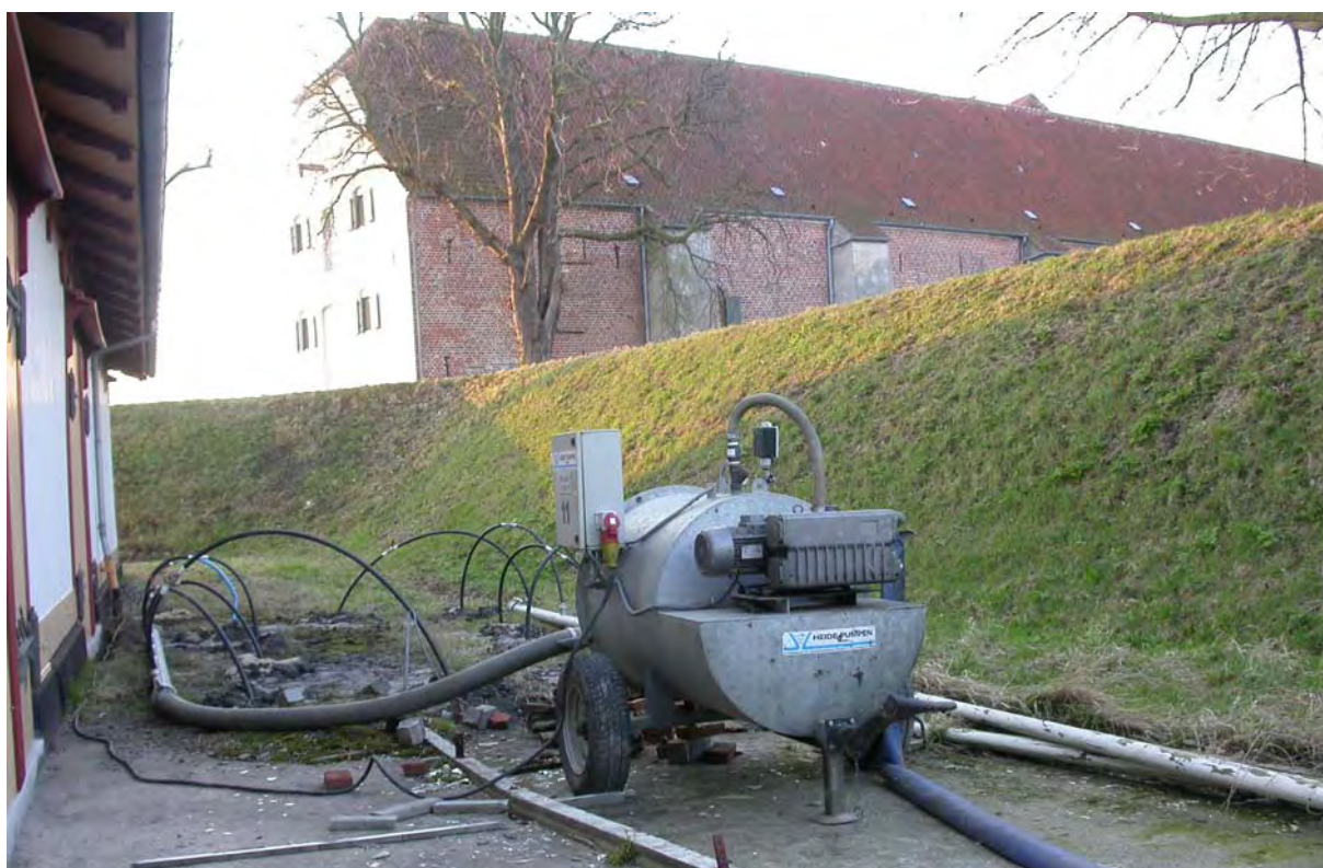
01322D04: sugespidserne markerer hvor spildevandstanken skal graves ned med volden og magasinbygningen i baggrunden.
